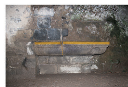
6. DEFORMAZIONE E ROTTURA
