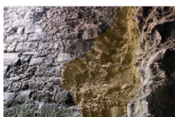
4. EROSIONE DEL MATERIALE LAPIDEO
