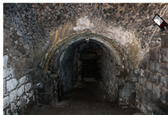
PERCOLAZIONE DI ACQUE NERE (FORNICE XXXVI)
