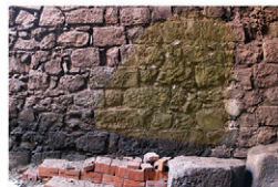
2. EFFLORESCENZA E PATINA BIOLOGICA
