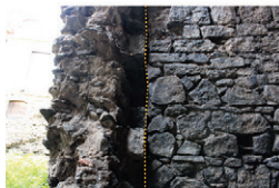
1. SCOLLAMENTO MURATURE ADIACENTI
