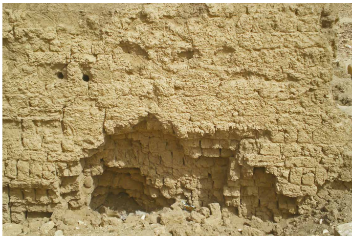
Fig. 15 Fenomeno di disfacimento di mattoni in terra cruda in corrispondenza dell'attacco a terra
