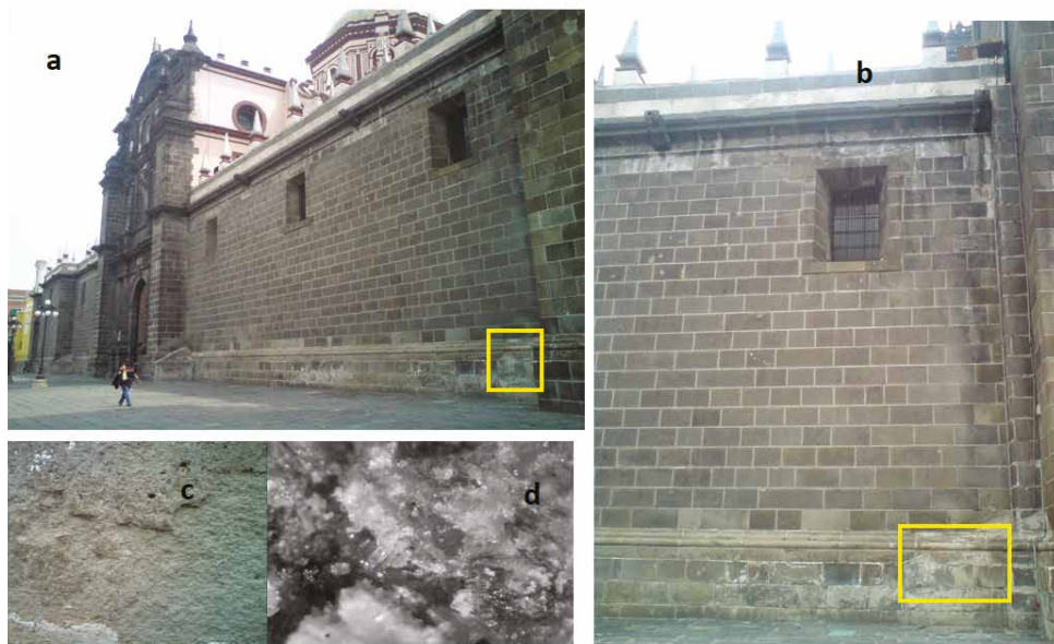
Fig. 5 Daño en el guardapolvos en fachada norte
