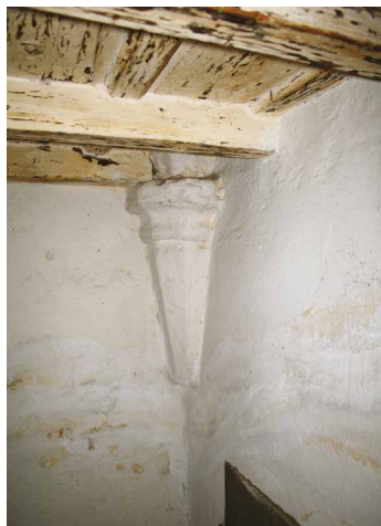
Fig. 8 Particolare di un peduccio in pietra della volta a crociera nascosta dal nuovo solaio ligneo. Dei quattro peducci oggi ne sono visibili soltanto due; gli altri sono stati inglobati nel rinfiacco della volta a botte sopra l'androne nord
