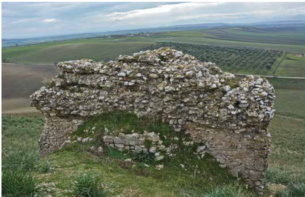
Fig.13 Tratto ovest della cinta muraria. La posizione sul pendio evidenzia il rischio di instabilità accentuato dal continuo dilavamento del terreno
