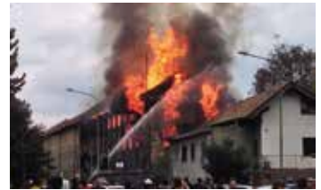
Fig. 4 Pinerolo (TO). Lavori di abbattimento del complesso della Fabbrica Elettrodi della Società Talco Grafite Val Chisone (foto: M. Calliero)
