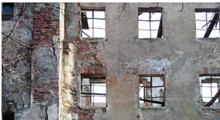
Fig. 20 Danni da fuoco alle pareti, all'orditura della copertura e alle travi metalliche che sostenevano i solai lignei d'interpiano del Follone di Pinerolo (foto: R. Rudiero)
