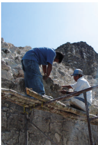
Fig. 10 Canalización de agua. En la imagen se observa la extensión de elementos arquitectónicos con el fin de canalizar el agua y evitar que escurra sobre aplanados originales. Zona arqueológica de Río Bec, Campeche, México. Archivo CNCPC-INAH
