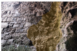
4. EROSIONE DEL MATERIALE LAPIDEO
