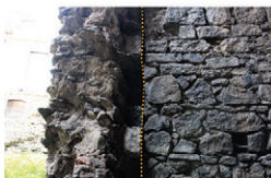
1. SCOLLAMENTO MURATURE ADIACENTI
