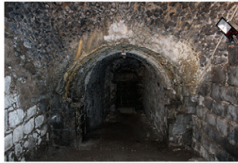
PERCOLAZIONE DI ACQUE NERE (FORNICE XXXVI)
