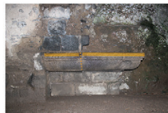
6. DEFORMAZIONE E ROTTURA
