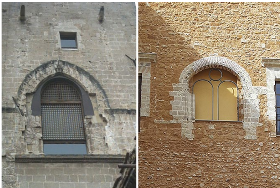
Figura 2. (A sinistra) Palermo, Palazzo Chiaromonte detto Steri, bifora del prospetto settentrionale in cui si è scelto di non reintegrare la colonnina centrale; (a destra) Agrigento, Palazzo Chiaromonte, poi Collegio dei Santi Agostino e Tommaso, bifora reintegrata con forme semplificate (foto R. Prescia, 2023).
