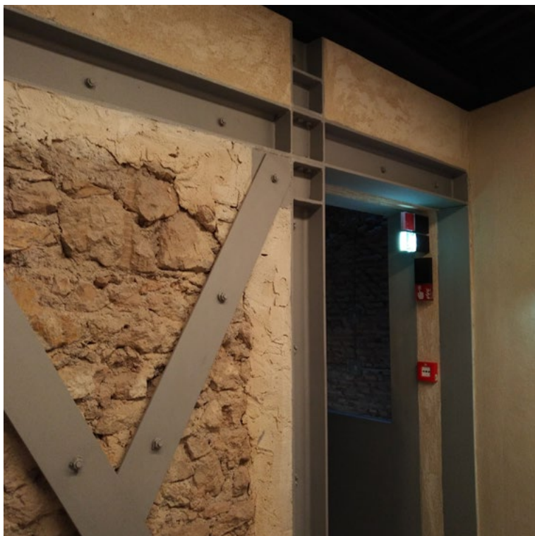
Figura 2. Roma, Palazzo del Velabro Rhinoceros , Fondazione Alda Fendi. Particolare del rinforzo strutturale antisismico della compagine muraria (Sistema CAM), utilizzato come matrice di scelte compositive (Marino, 2021).
