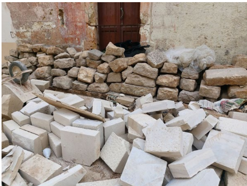
Figura 2. Gallipoli, (LE), via della città storica intramoenia. Particolare di un rifacimento stradale moderno. Come si nota sono stati divelti i basoli appartenenti alla storica copertura, per fare posto ad una pavimentazione moderna fatta da lastre in pietra (foto, G. Occhilupo, 2024).
