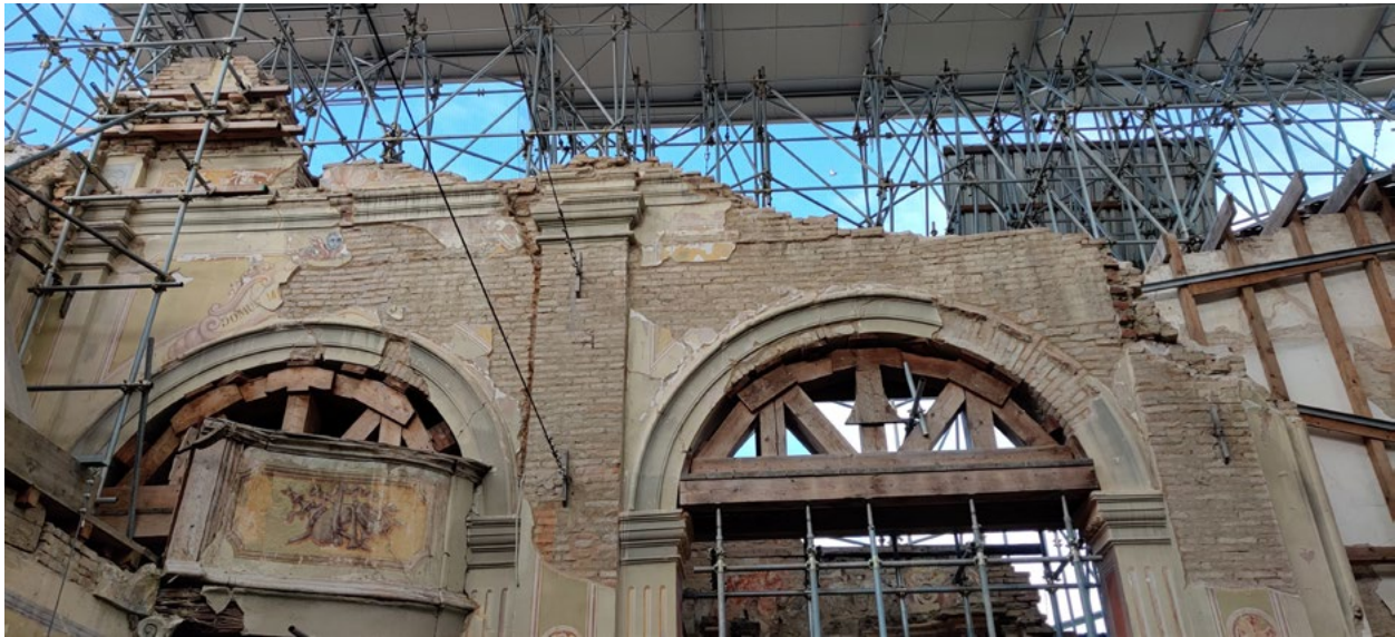
Figura 1. San Felice sul Panaro (MO), Duomo, particolare del cleristorio crollato, (foto B. Letizia, 2021).
