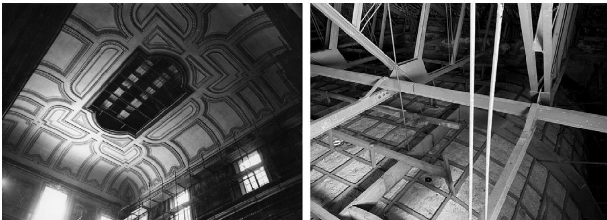
Figura 3. Napoli, Palazzo Reale, a destra: la volta della Cappella Palatina a seguito dei restauri degli anni Settanta del XX secolo (1977) © AfSABAPna, F 30157; a sinistra: particolare dell'estradosso della volta, (foto Antonio Festa 2023).
