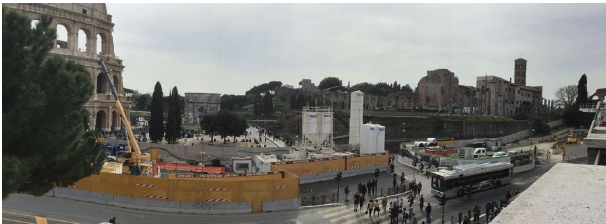
Figura 3. Roma città UNESCO, il cantiere della Metro C nell'area del Colosseo (foto M. G. Turco, 2023).
