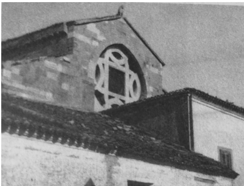
Figura 3. Troia (FG), Concattedrale della Beata Vergine Maria Assunta in Cielo, il rosone absidale progettato dall'Arch. Travaglini in cui è possibile vedere anche gli edifici addossati alla facciata che impedivano di ammirare l'abside © Museo Diocesano, Troia.
