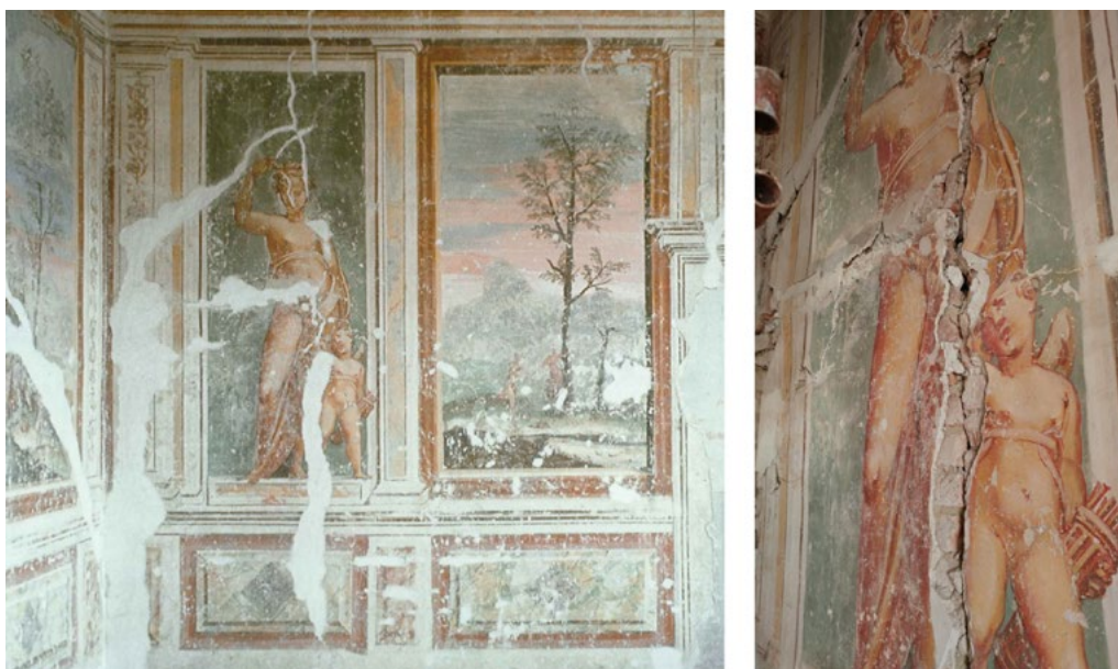
Figura 4. Moglia, Villa Galvagnina, apparato decorativo di un locale del piano superiore negli anni '90 (a sinistra: foto F. Cavazzoli, 1990, ©Archivio privato Cavazzoli) e dopo il sisma del 2012 (a destra: foto V. M. Nannei, 2016).
