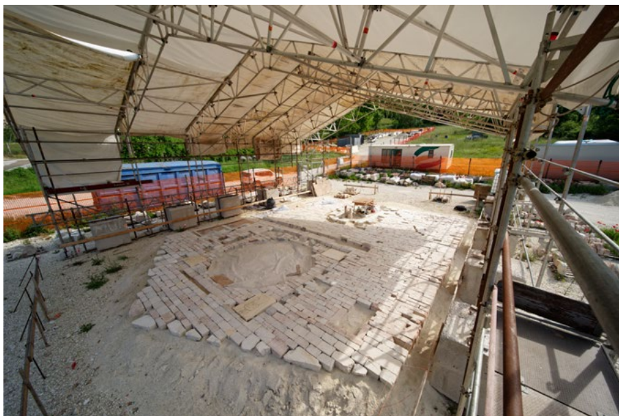
Figura 4. Anastilosi del paramento della facciata della chiesa di Sant'Eutizio (foto P. Pettinari, 2024).
