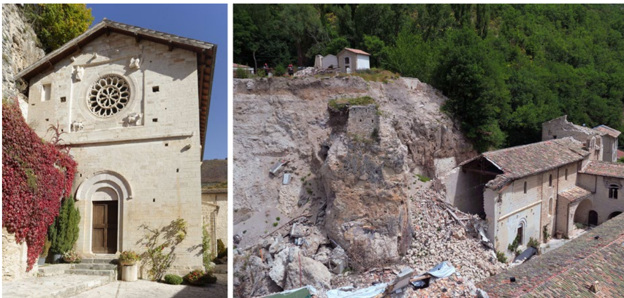
Figura 1. La Chiesa di Sant'Eutizio a Preci prima e dopo il crollo provocato dal terremoto del 2016 (a sinistra: foto M. Chiappini; a destra: https://www.sismaumbria2016.it/articolo/heartquak-europe-supports-umbria-bruxelles-dall8-ottobre ).
