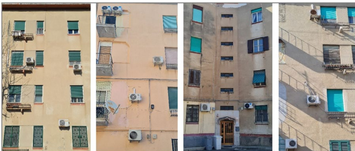
Figura 2. Alloggi per lavoratori di F. Rovigo: la centralizzazione degli impianti favorisce il risparmio energetico ed elimina i macchinari in vista sul prospetto (foto G. Currò, R. Lione, F. Minuitoli, 2024).
