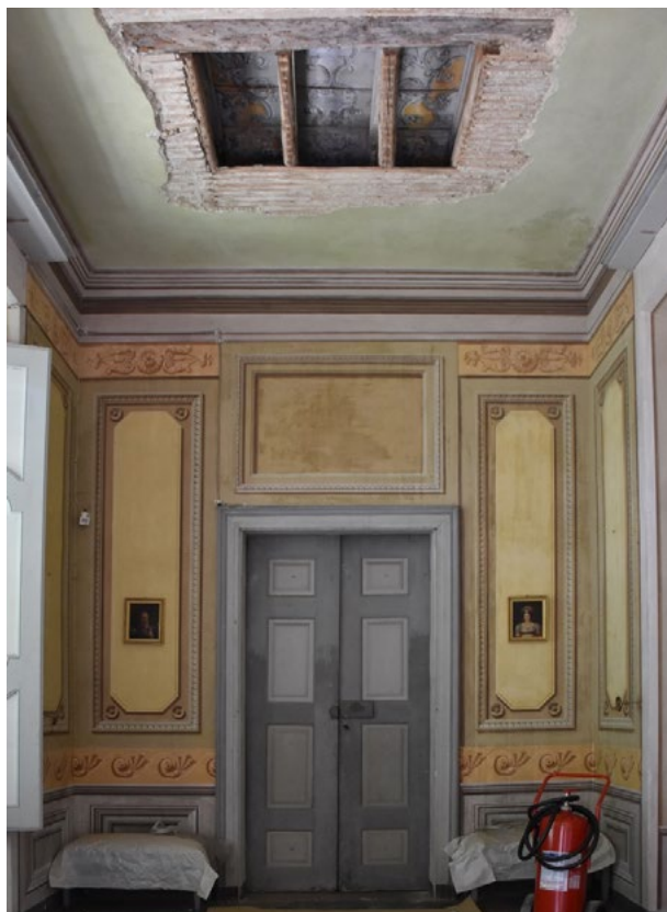
Fig. 5 Castello di Agliè, apertura nel plafone ligneo ottocentesco della Galleria dei morti , 2023. Si intravede la decorazione all'intradosso del solaio preesistente, emersa in seguito alla campagna di indagini diagnostiche condotta nel 2007 (foto D. Arpellino 2022).
