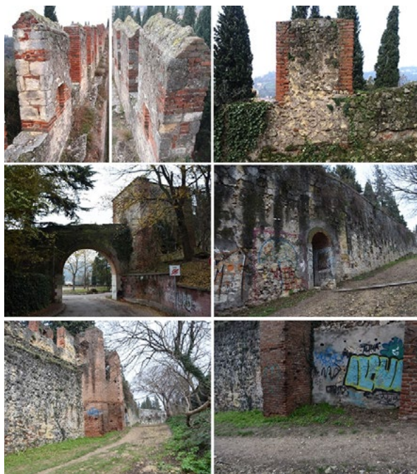
Fig. 3 Alcune viste dello stato di conservazione delle mura (riprese fotografiche e da drone, 2020).
