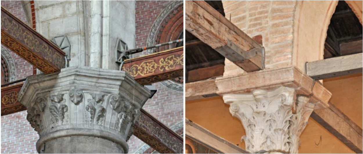
Fig. 1. A sin. Venezia, chiesa dei SS. Giovanni e Paolo, peduccio di una colonna sul lato sinistro della navata centrale dove sono visibili le piastre in ghisa e i tiranti tesi sopra le travi lignee foderate e decorate (foto L. Scappin, 2017); a destra, Torcello, chiesa di S. Maria Assunta, peducci di colonna del alto sinistro con i tiranti lignei e le staffe di fissaggio (foto L. Scappin, 2017)
