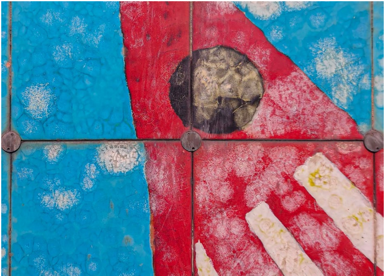
Fig. 4 Napoli, partito decorativo di Paolo Ricci collocato sulla facciata principale della sede della Facoltà di Architettura di Piazzale Tecchio. Stato di conservazione delle piastrelle ceramiche in cui si evidenziano delle concrezioni minerali che hanno alterato la consistenza e il colore delle stesse (foto S. Iaccarino 2022).
