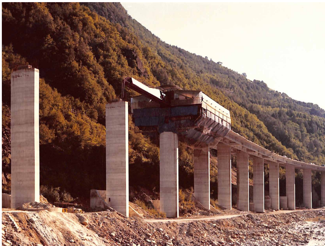
Fig. 2 - Viadotto Campodazzo: realizzazione impalcato, 1965/75 (foto: Chiolini & C., Pavia. Fondazione ing. Lino Gentilini).
