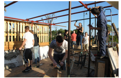
02 | Studenti al lavoro per la riqualificazione dello spazio pubblico di Genova Pegli, foto di Riccardo Rossi e Amedeo Scofone Students working on the requalification of public space in Genoa Pegli, photo by Riccardo Rossi and Amedeo Scofone
