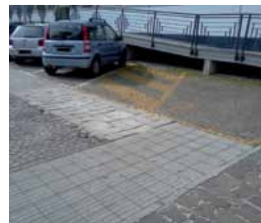
02 | Parcheggio accessibile di una struttura sportiva e residenziale per studenti; le soluzioni tecniche appaiono inefficienti rispetto ai requisiti d'uso richiesti (foto C. Conti).
