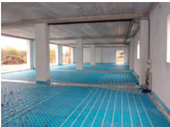
17 | Liceo Scientifico Majorana: Fase di cantiere. Messa in opera del pavimento radiante Majorana School: construction of radiant floor
