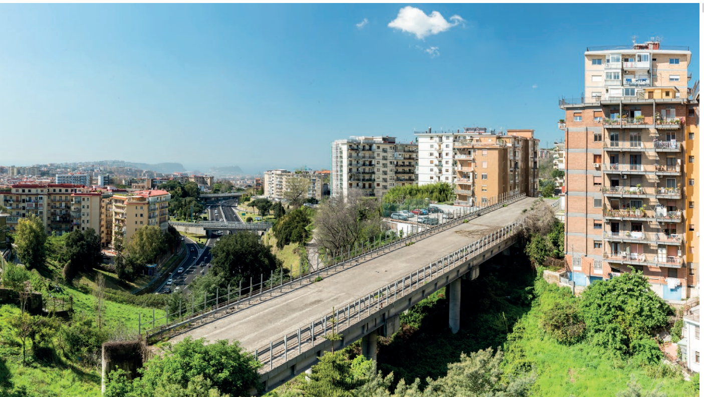
4 | Viadotto San Giacomo dei Capri, Napoli da "Incompiuto Siciliano" di Alterazioni Video, 2018, photo credit: Alterazioni Video Viadotto San Giacomo dei Capri, Napoli from "Incompiuto Siciliano" of Alterazioni Video, 2018, photo credit: Alterazioni Video
